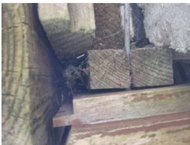
Mangler musesperre i hjørnekasse.
