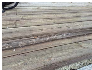
Råte i terrassebord.
