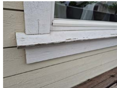
Mangler beslag i underkant av vindu.
