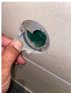
Ufagmessig utførelse membranmansjett.
