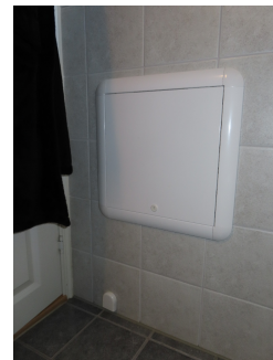
Samleskap for trykksatte rørføringer på bad i 2.etg. dreneringsrør ført ut på gulv for identifisering av event. lekkasje.
