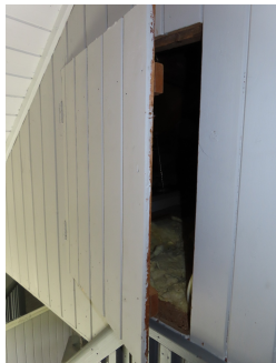
Uisolert dør av trepanel fra trappegang inn til kneloftet. Vegg og døren har ingen isolerende egenskaper, og vil med dette slippe varm inneluft inn på kneloftet og forårsake kondensering i takkonstruksjonen.
