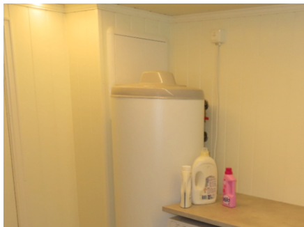
Samleskap for trykksatte rørføringer i vegg bak bereder (vanskelig å åpne - er ikke inspisert innv.).
