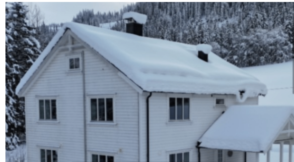
Svært tydelig at det er varmegjennomgang i takkonstruksjonen ved at snøen på taket smelter ihht inneforliggende konstruksjoner med varmegjennomgang.
