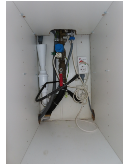
Hovedvanninntaksledning med hovedstoppekran og magnetventil for waterstop-system.
