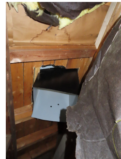
Det er etablert en luftehatt inn på kneloftet for å imøtekomme og prøve å få tilstrekkelig utlufting av dette for å unngå kondensering.
