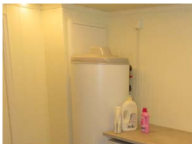
Samleskap for trykksatte rørføringer i vegg bak bereder (vanskelig å åpne - er ikke inspisert innv.).
