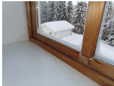
Ett av vinduene på soverom i 2.etg. Det er registrert kondensmerker på karm og ramme - merk alder.
