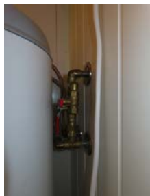
Stoppekran på vegg bak bereder.
