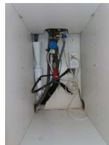
Hovedvanninntaksledning med hovedstoppekran og magnetventil for waterstop-system.
