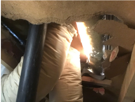
Utettheter rundt takgjennomføringer
