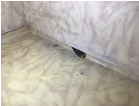
Løst belegg i dusj
