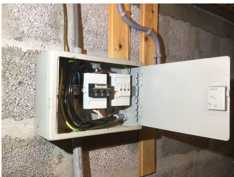
Hovedsikring i kjelleren
