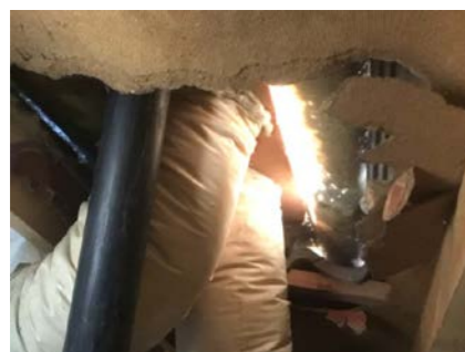
Utettheter rundt takgjennomføringer
