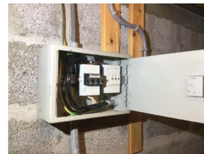
Hovedsikring i kjelleren
