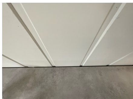
Mangler stedvis silikonefuge i overgangen benkeplate/vegg.
