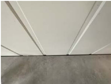
Mangler stedvis silikonfuge i overgangen benkeplate/vegg.
