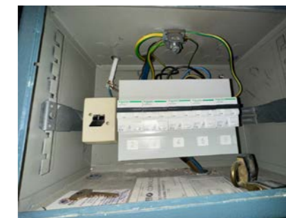
Sikringsskap med automatsikringer.
