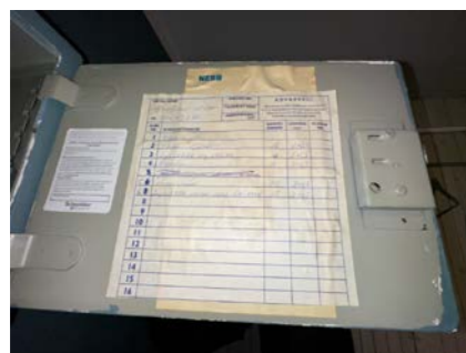
Kursoversikt i sikringskap
