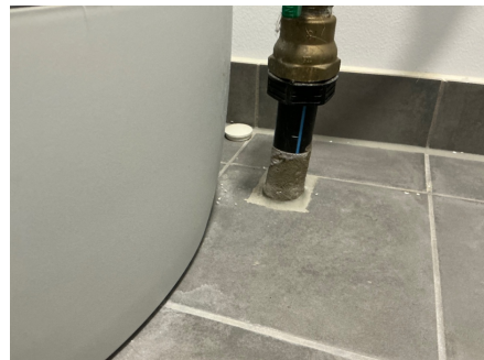
Mansjett på rør-føring
