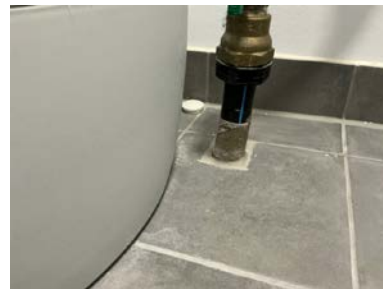
Mansjett på rør-føring
