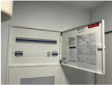
Sikringskap står i vaskerom.
