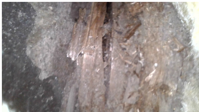
Tørråte inne i utlektet vegg øst side
