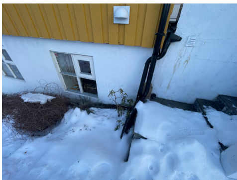
Bortledning av vann på vest side
