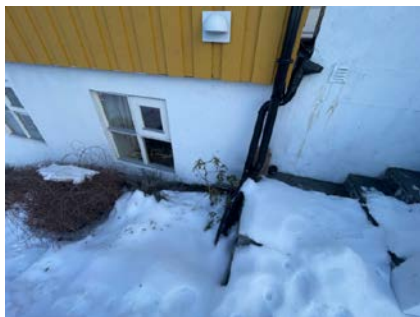
Bortledning av vann på vest side
