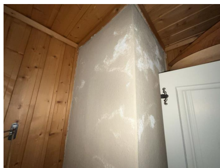
Saltutslag på pipe.
