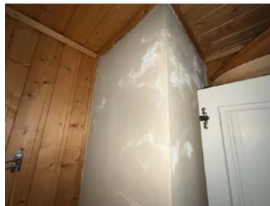
Saltutslag på pipe.
