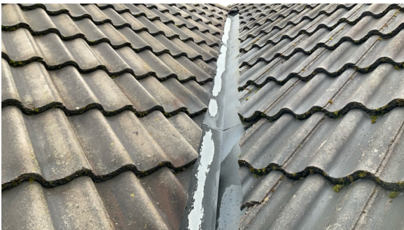
Overflatebehandling på gradrennebeslag flasser.
