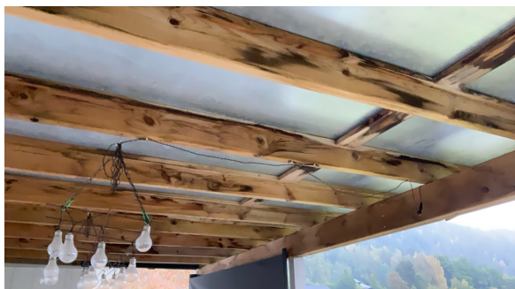
Noen lekkasje i tetting under veranda på etasjeplan.
