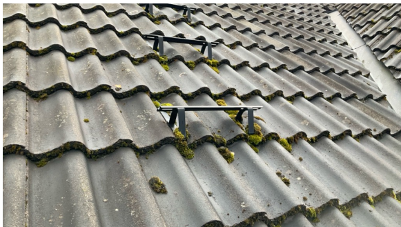
Mose og slitasje på takstein
