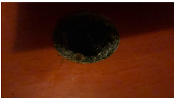
Sluk i gulv.
