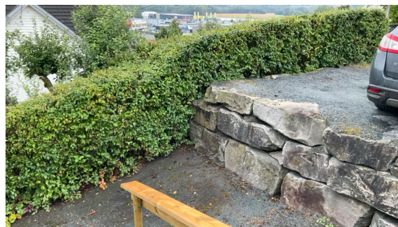
Støttemur i stein i forbindelse med parkering mangler sikring.
