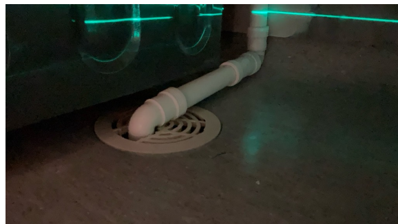
Avløp fra vaskemaskin går i rør over gulv til sluken
