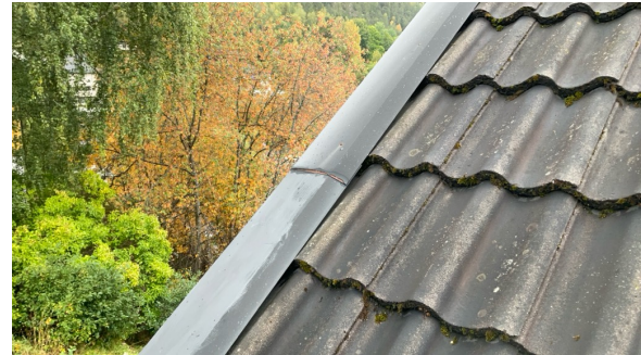
Rust på vinds kibeslag.
