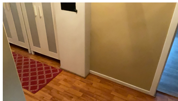
Manglende brannsikring på gulv under sotluken
