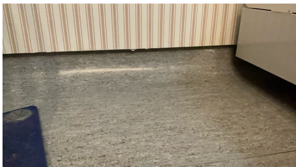
Manglende tetting i nedre kant av våtromsplater.
