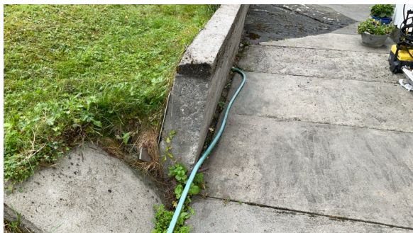
Skjevhet i støttemur ved inngang.
