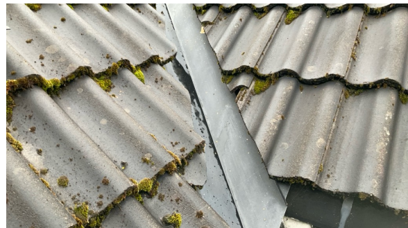
Enkelte knekte takstein i gradrenner.
