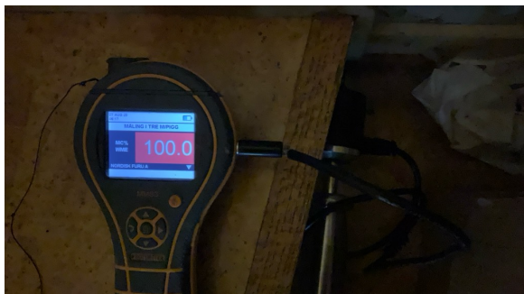
Fult utslag på fuktmåling med hammerelektrode.
