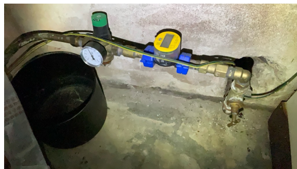
Stoppekran og vannmåler.
