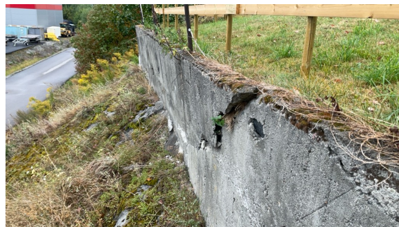
Sprekk i støttemur på nedre nivå.
