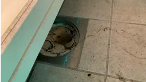
Sluk under dusjkabinett.
