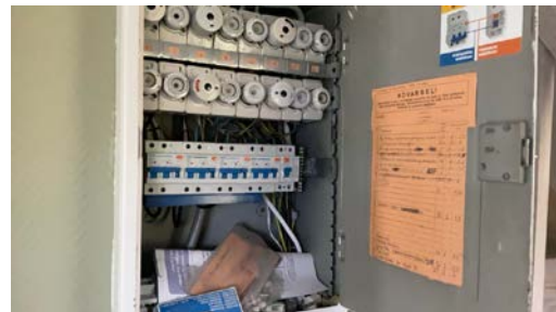
Sikringsskap på etasjeplan
