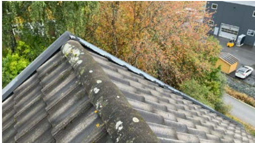
Maling flasser på beslag på vindskier.
