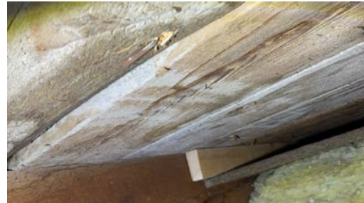
Synlig luftespalte mellom undertak og isolasjon
