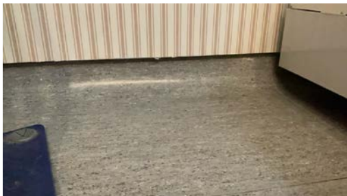
Manglende tetting i nedre kant av våtromsplater.
