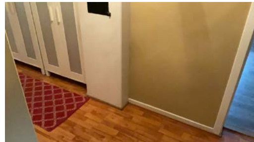
Manglende brannsikring på gulv under sotluken
