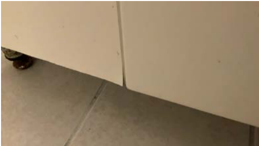
Fuktsvelling på front på innredning.
