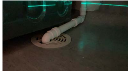
Avløp fra vaskemaskin går i rør over gulv til sluken
