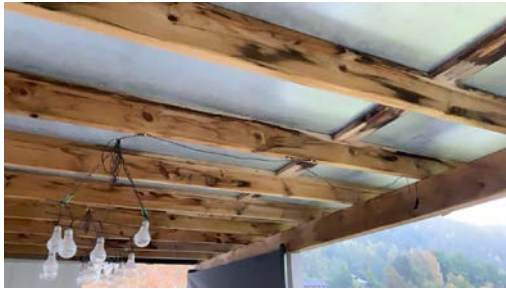
Noen lekkasje i tetting under veranda på etasjeplan.
