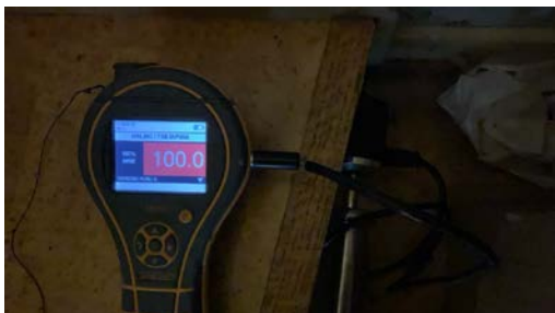
Fult utslag på fuktmåling med hammerelektrode.
