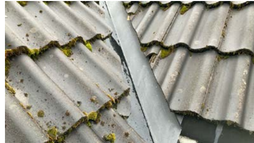
Enkelte knekte takstein i gradrenner.
