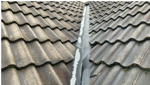
Overflatebehandling på gradrennebeslag flasser.
