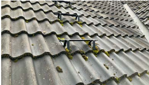
Mose og slitasje på takstein
