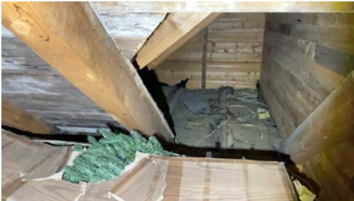
Det er begrenset tilgang til konstruksjonen.
