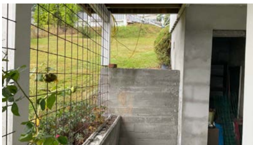
Støttemur på nedre nivå uten sikring i toppen
