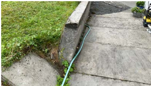
Skjevhet i støttemur ved inngang.
