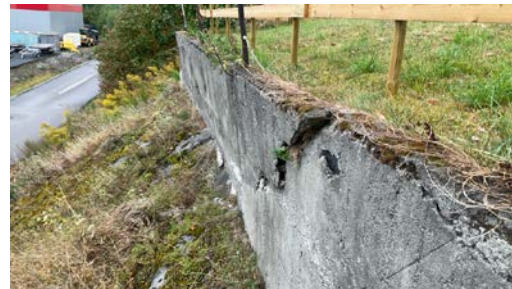
Sprekk i støttemur på nedre nivå.
