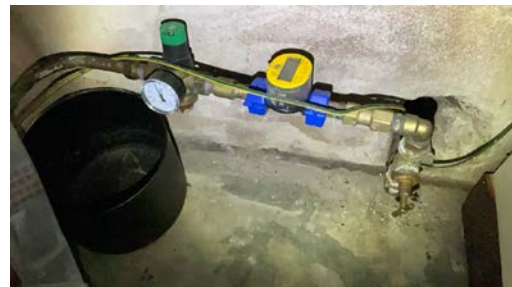
Stoppekran og vannmåler.
