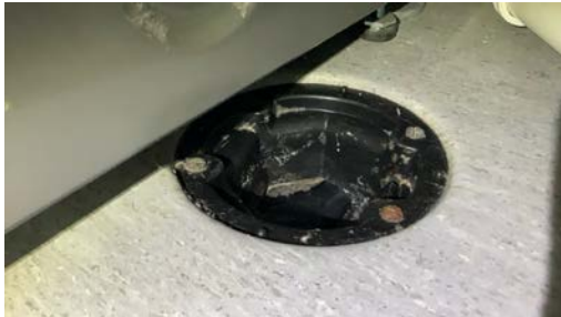
Plastsluk i gulv.
