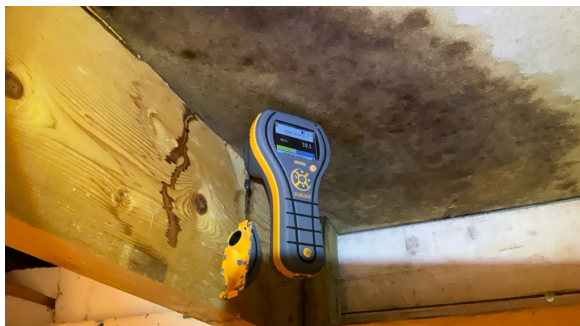
Fukt gjennomtrenging, synlig fra garasje i underetasje. Det er målt forhøyede verdier i sponplate.
