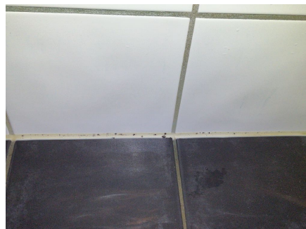
Misfarget silikonfuger i dusjsonen.
