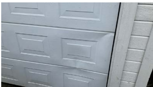
Bulker i garasjedør er registrert.
