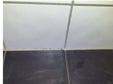
Misfarget silikonfuger i dusjsonen.
