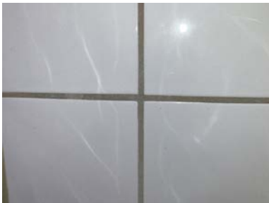
Slitte/misfarget fuger i dusjsonen.
