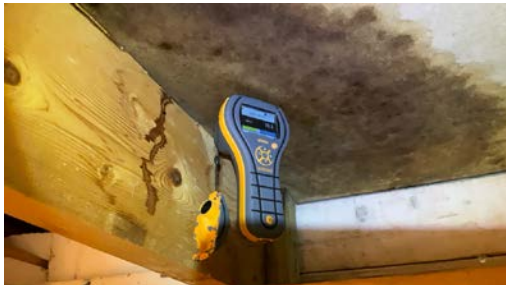
Fukt gjennomtrenging, synlig fra garasje i underetasje. Det er målt forhøyede verdier i sponplate.
