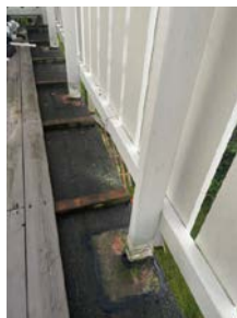
Stolper på terrasse mot vest, forrige eier har utbedret med fugemasse.
