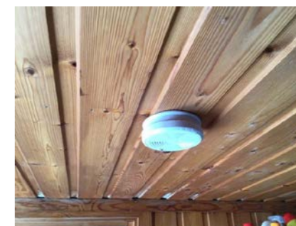
Eksempel på montert røykvarsler.
