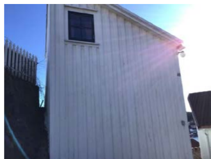
Del av vegg på tilbygg.
