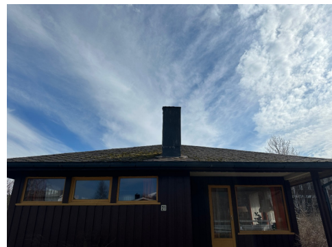
Manglende stigetrinn for feier.
