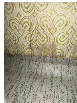
Løs tapet nede mot gulv i dusjsone.
