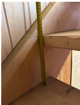
Store åpninger mellom trinn i trapp.
