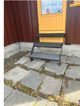
Trapp ved balkongdør til stue.
