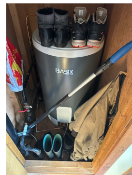
Varmtvannsbereider på lukket rom.
