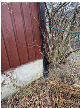
Ingen synlig fuktsikring mot mur utvendig.
