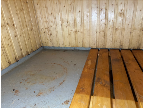
Åpning mellom panel og gulv.
