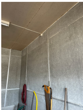
Asbest plater på vegger i garasje.
