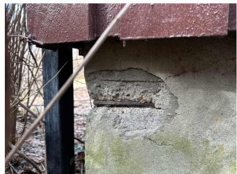
Skade i utvendig mur. Synlig armeringsjern.
