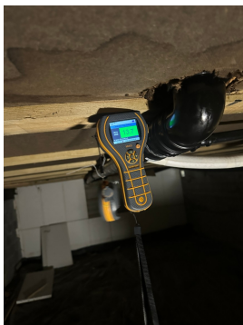
Fuktmåling under bad ved rørgjennomføring.
