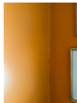
Tørkesprekker i hjørnet på kjøkkenet.
