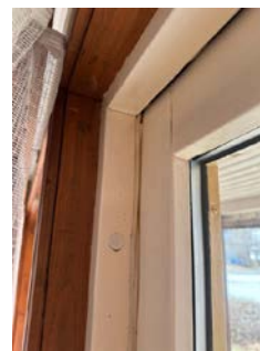
Ekstra pakning på balkongdør mot øst.
