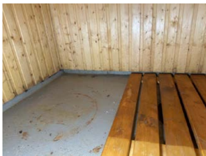
Åpning mellom panel og gulv.
