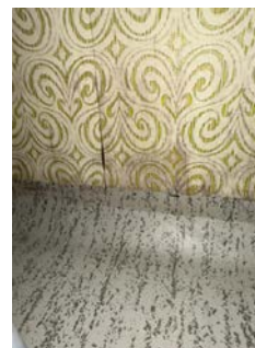
Løs tapet nede mot gulv i dusjsone.
