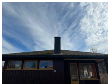
Manglende stigetrinn for feier.
