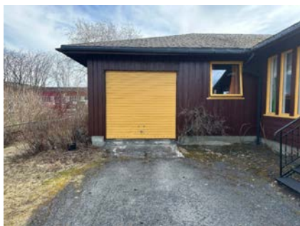
Synkegroper i asfalt
