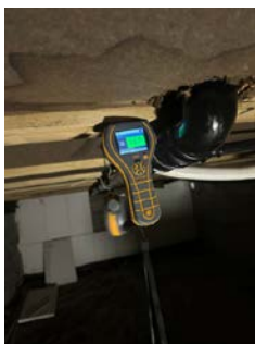
Fuktmåling under bad ved rørgjennomføring.
