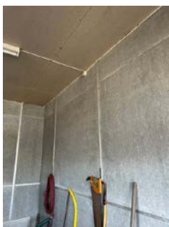
Asbest plater på vegger i garasje.
