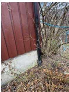
Ingen synlig fuksikring mot mur utvendig.
