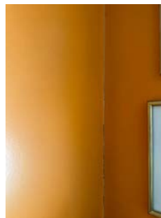
Tørkesprekker i hjørnet på kjøkkenet.
