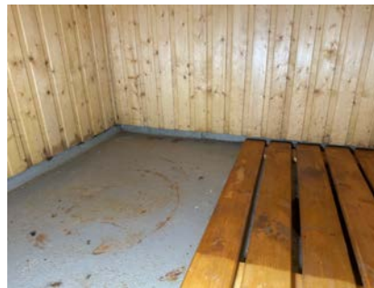
Skjult støpejerns sluk under gulvplater i dusjrom.
