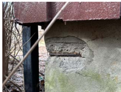
Skade i utvendig mur. Synlig armeringsjern.
