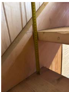
Store åpninger mellom trinn i trapp.
