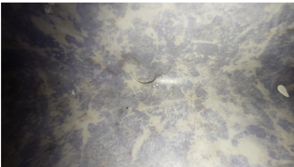
Hull i belegget.
