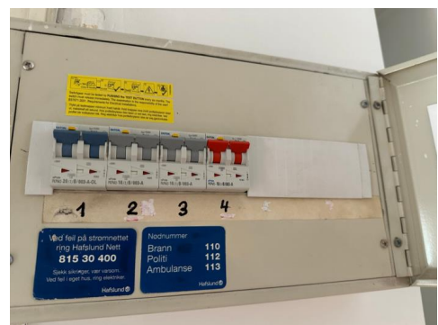
Sikringsskap med automatsikringer.
