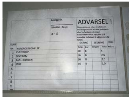
Kursoversikt i sikringskap
