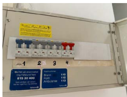
Sikringskap med automatsikringer.
