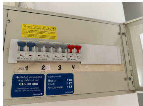
Sikringskapp med automatsikringer.
