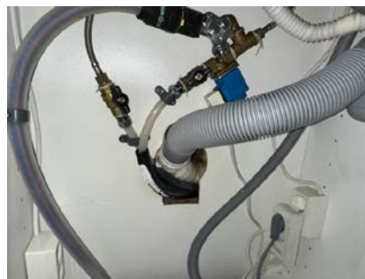
Rørpropp i kjøkkenbenk med Waterguard
