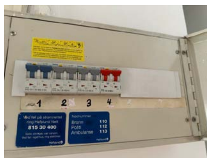
Sikringskap med automatsikringer.
