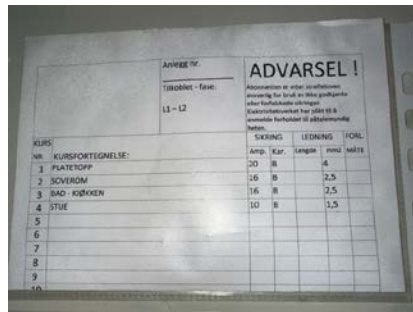
Kursoversikt i sikringskap
