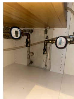
Stoppekraner plassert på kjøkken
