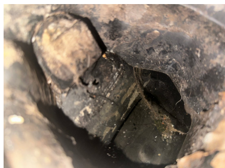
Sluk i plast, plassert under dusjkabinett
