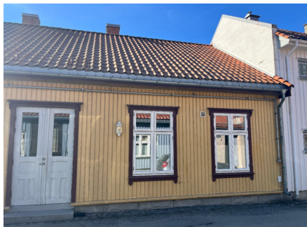
Mangler snøfangere mot gate
