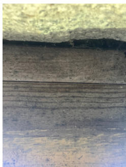
Ingen luftespalte under vannstokk, mot gate.
