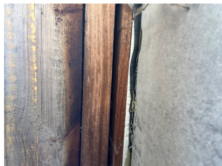
Luftespalte på vegg mot gårdsrom, ok.
