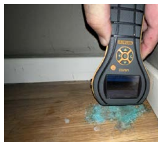
Merke på parkett under kjøleskap, ikke fukt.
