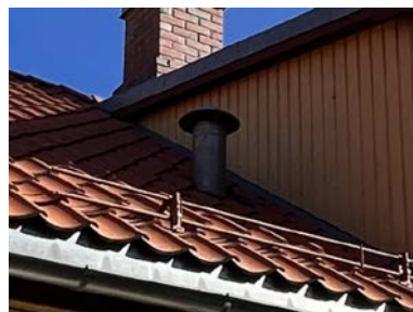
Luftehatt for kloakk luftingen
