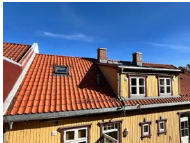
Mangler snøfangere på deler av taket inn mot gårds plass. Mangler takstige.
