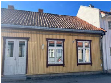
Mangler snøfangere mot gate
