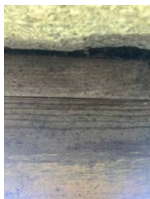
Ingen luftespalte under vannstokk, mot gate.
