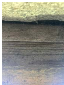
Ingen luftespalte under vannstokk, mot gate.
