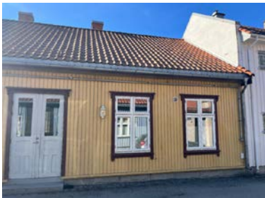
Mangler snøfangere mot gate
