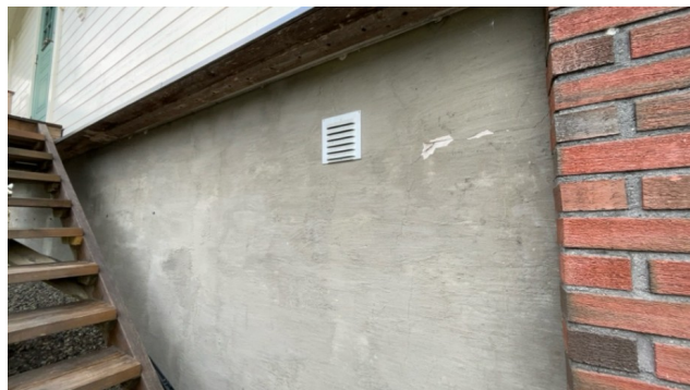
Stedvis behov for lokale utbedringer.
