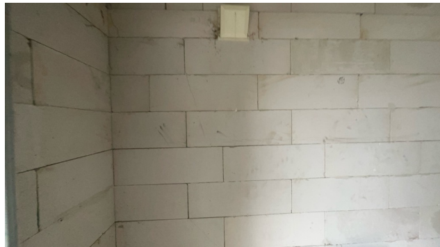
Lokalt riss i grunnmur.
