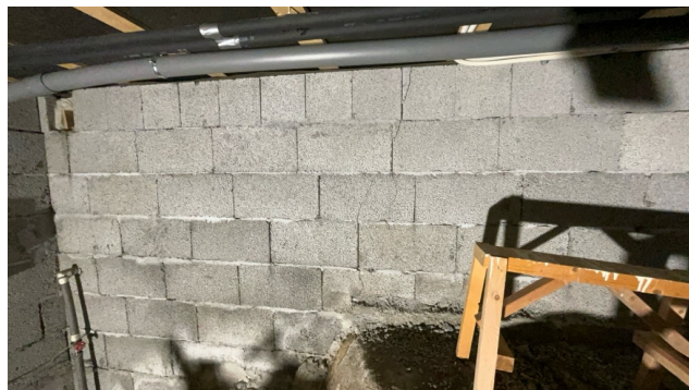
Synlig riss på grunnmur i kryprom.
