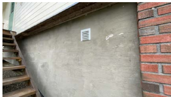
Stedvis behov for lokale utbedringer.
