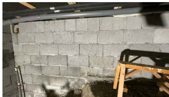
Synlig riss på grunnmur i kryprom.
