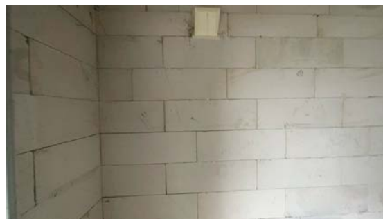
Lokalt riss i grunnmur.
