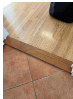
Bildet viser terskel med sprekke.
