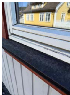
Bildet viser utvendig vindu med flassende maling på karm og ramme.
