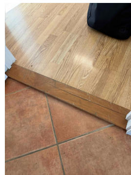
Bildet viser terskel med sprekk.
