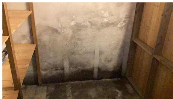
Eksempel på fuktpåkjenning på grunnmur.
