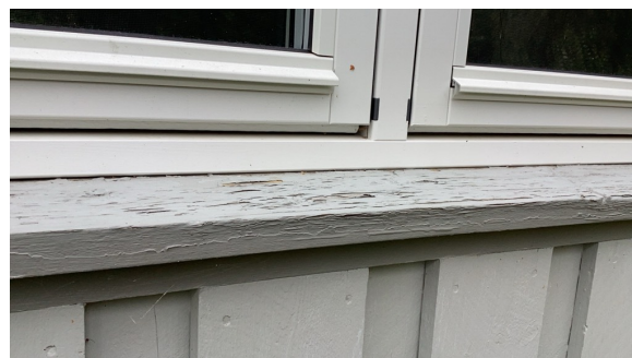
Vannbrett uten beslag, stedvis slitasje.
