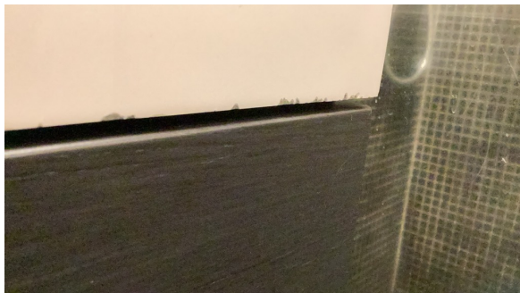
Små skader på undersiden av vask.
