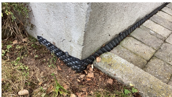
Eksempel på sprekk i grunnmur.
