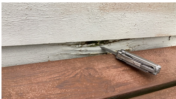
Råte i treverk ved trapp.
