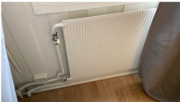
Radiatorer fra byggeår.
