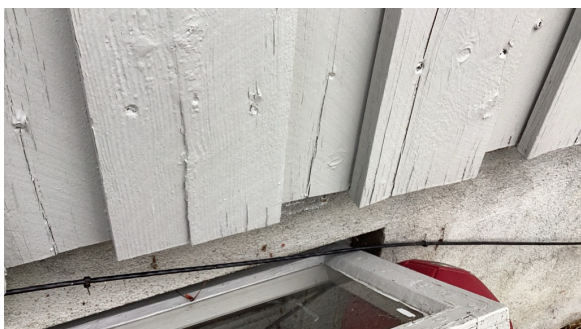
Eksempel på sprekker i kledningsbord.
