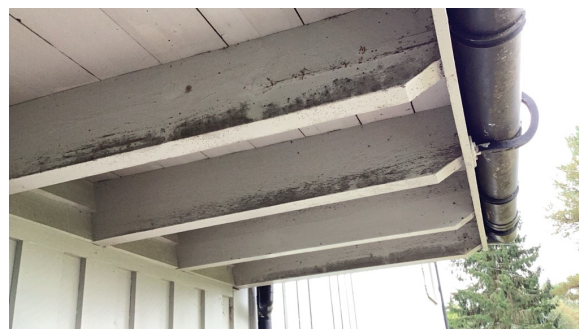
Svertesopp på undersiden av balkong.
