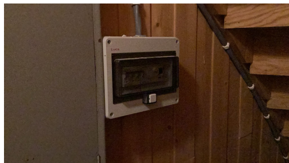
Sikring for varmepumpe.
