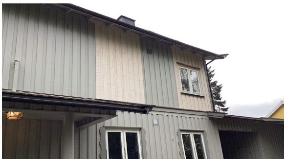
Det gjenstår behandling av skiftet kledning.
