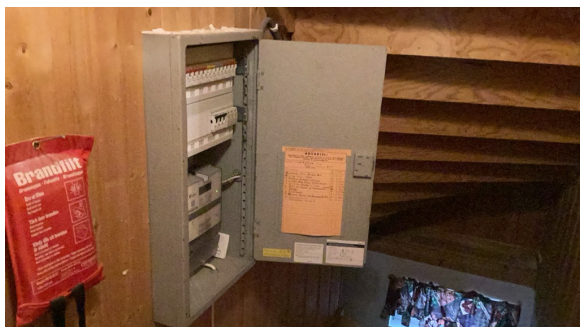
Sikringsskap for kjeller og 1. etasje.
