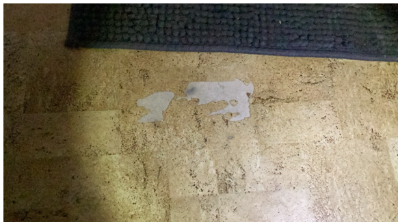
Skade på gulvbelegg på kjøkken.
