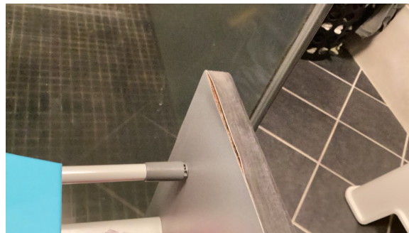
Folie på fronter på servantinnredning begynner å løsne.
