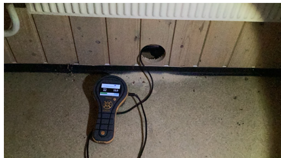
Fuktmåling i utforet vegg mot terreng
