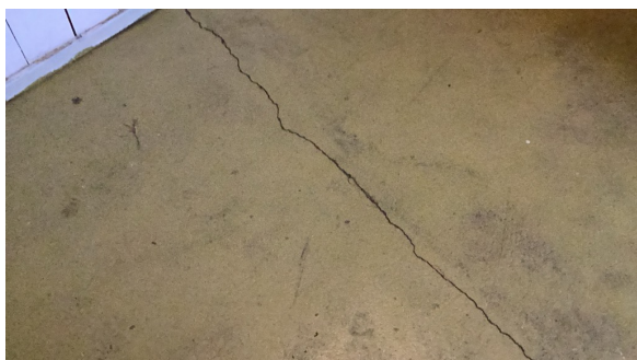
Sprekk i betonggulv.
