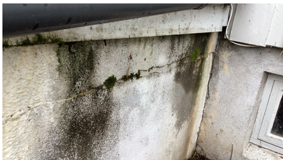
Eksempel på sprekk i grunnmur.
