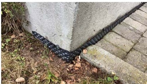
Eksempel på sprekke i grunnmur.
