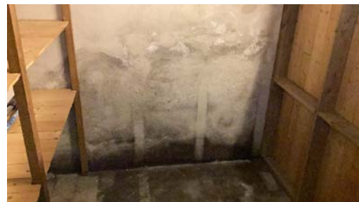
Eksempel på fuktpåkjenning på grunnmur.
