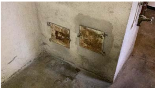
Sotluke i kjeller.
