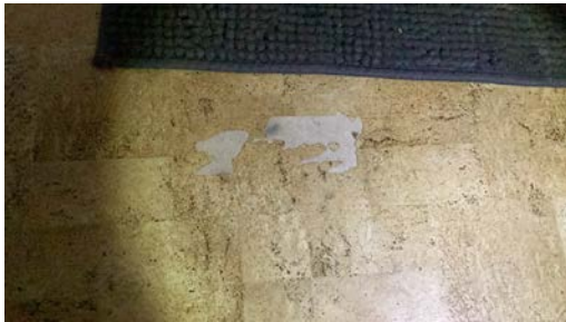
Skade på gulvbelegg på kjøkken.
