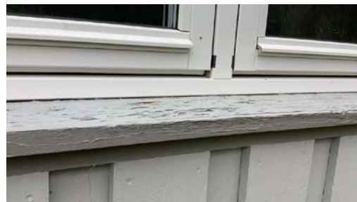
Vannbrett uten beslag, stedvis slitasje.
