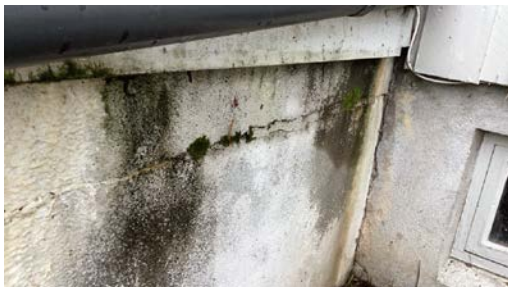
Eksempel på sprekk i grunnmur.
