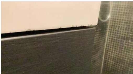
Små skader på undersiden av vask.
