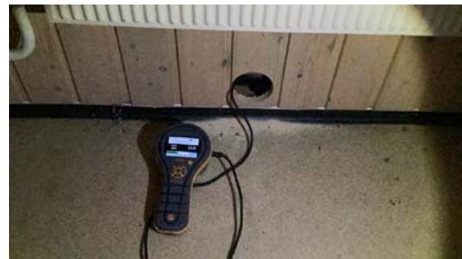
Fuktmåling i utforet vegg mot terreng
