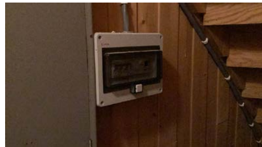
Sikring for varmepumpe.
