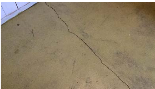
Sprekk i betonggulv.
