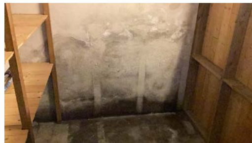
Eksempel på fuktpåkjenning på grunnmur.
