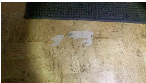
Skade på gulvbelegg på kjøkken.
