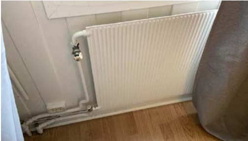
Radiatorer fra byggeår.
