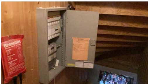
Sikringsskap for kjeller og 1. etasje.
