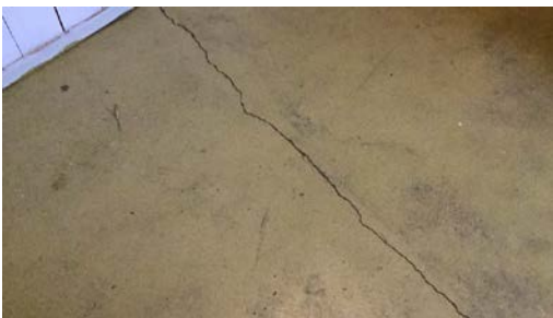
Sprekk i betonggulv.
