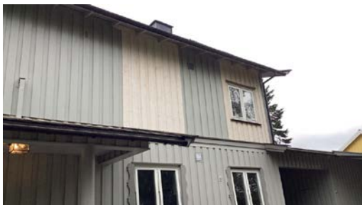
Det gjenstår behandling av skiftet kledning.
