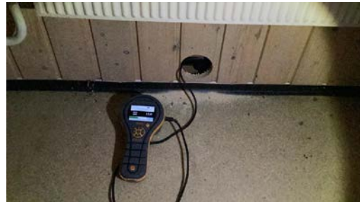
Fuktmåling i utforet vegg mot terreng
