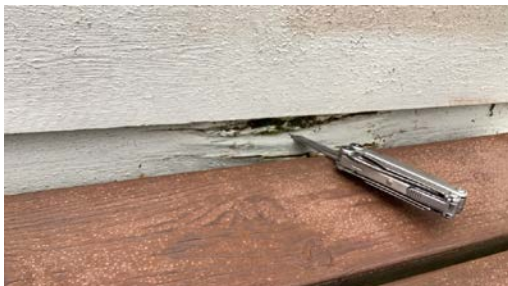
Råte i treverk ved trapp.
