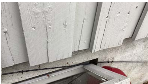
Eksempel på sprekker i kledningsbord.
