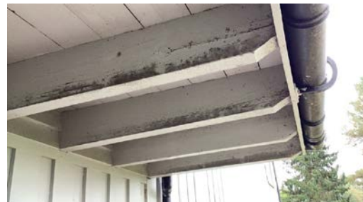
Svertesopp på undersiden av balkong.
