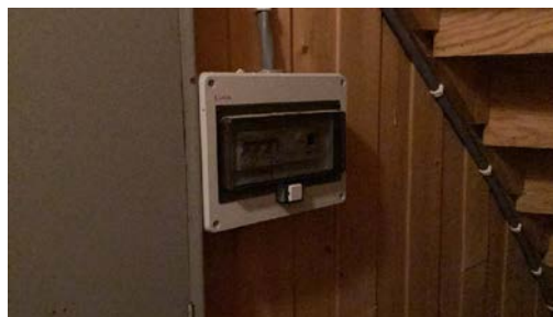
Sikring for varmepumpe.
