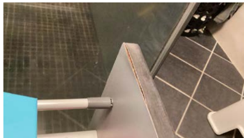
Folie på fronter på servanttinnredning begynner å løsne.
