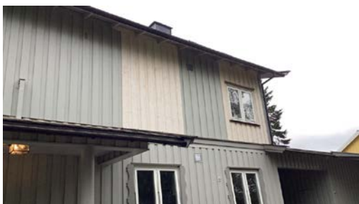
Det gjenstår behandling av skiftet kledning.
