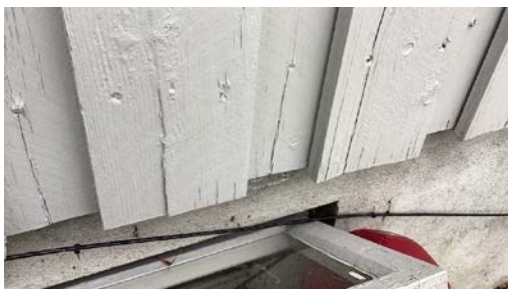
Eksempel på sprekker i kledningsbord.
