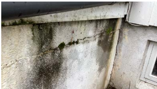
Eksempel på sprekke i grunnmur.
