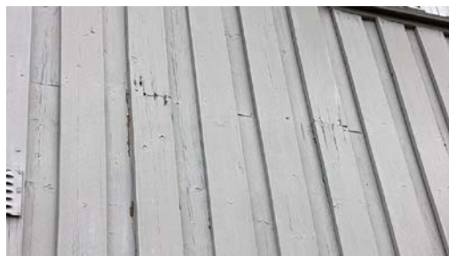
Eksempel på punkter på fasade som kan ha lokal råte.
