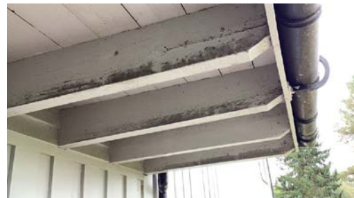
Svertesopp på undersiden av balkong.
