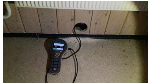
Fuktmåling i utforet vegg mot terreng
