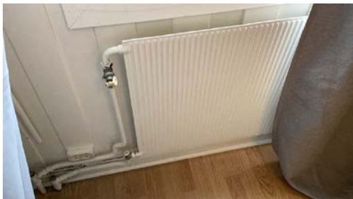
Radiatorer fra byggeår.
