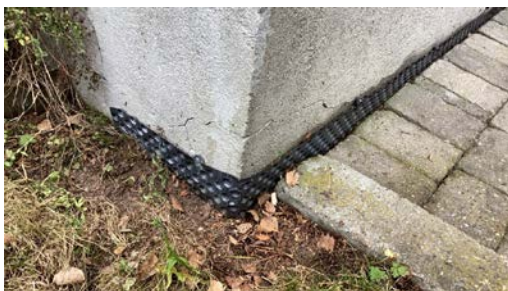
Eksempel på sprekke i grunnmur.
