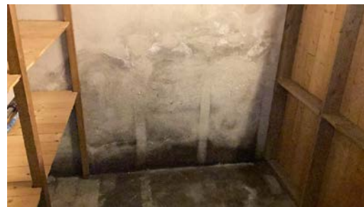
Eksempel på fuktpåkjenning på grunnmur.
