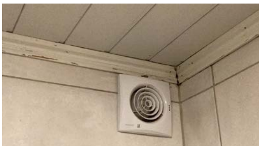
Slitasje på listverk.
