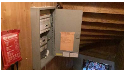
Sikringsskap for kjeller og 1. etasje.
