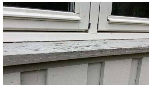
Vannbrett uten beslag, stedvis slitasje.
