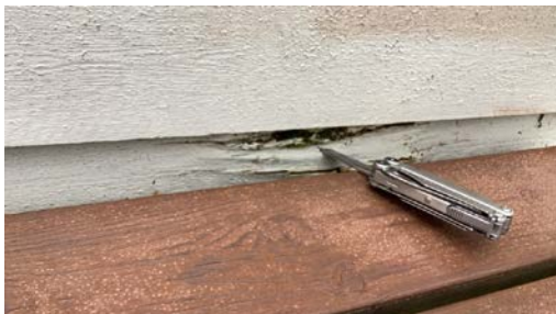
Råte i treverk ved trapp.
