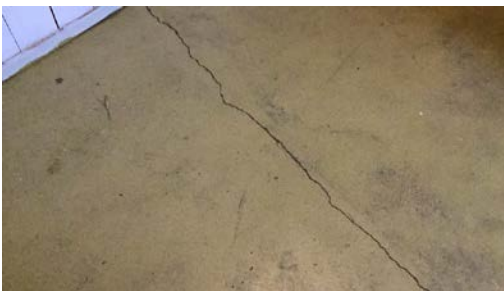
Sprekk i betonggulv.
