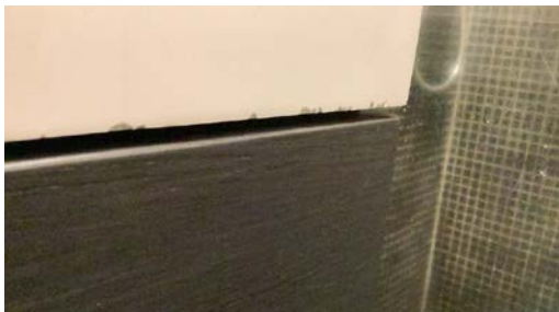
Små skader på undersiden av vask.
