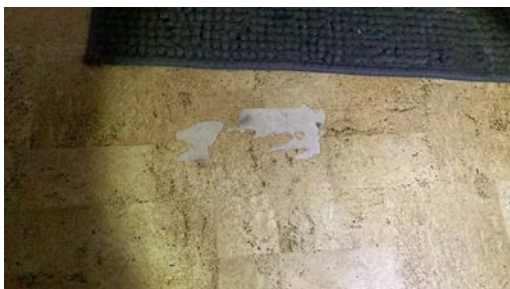
Skade på gulvbelegg på kjøkken.
