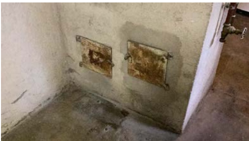
Sotluke i kjeller.
