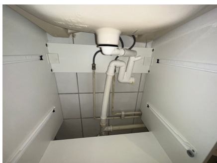
Rørøpplagg under servant på bad
