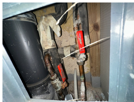
Stoppekraner plassert på bad
