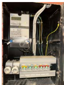
Sikringsskap med automatsikringer.
