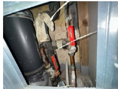
Stoppekraner plassert på bad
