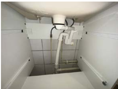
Rørøpplagg under servant på bad
