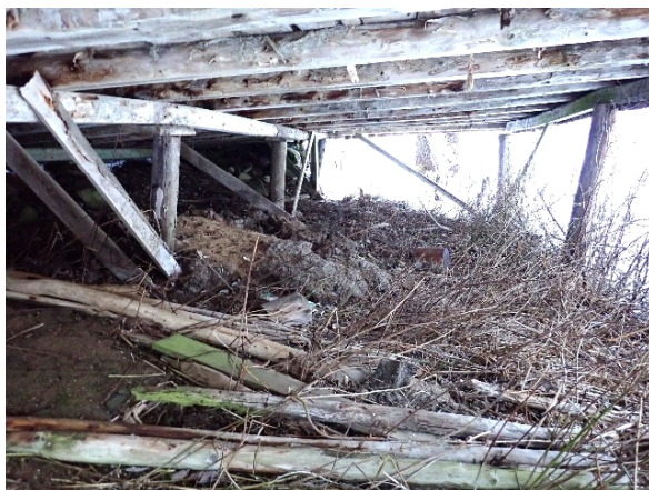
Sommerfjøs: Fundamentering er i ferd med å kollapse.
