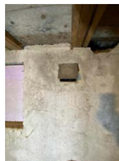
Ventilering av kjeller via veggventiler.
