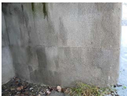
Sprekker og riss i mur på tilbygget del.
