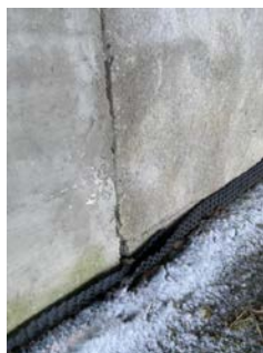
Sprekk i overgang mellom tilbygget del og hoveddel,.
