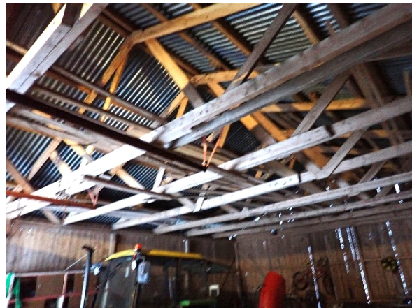
Redskapshus: Svak takkonstruksjon.
