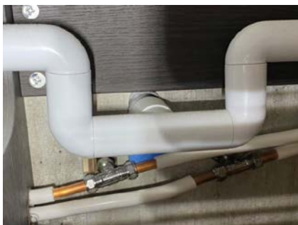
Utett rørgjennomføring i vegg.
