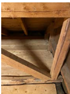
Det er ingen lufting ut over raft.
