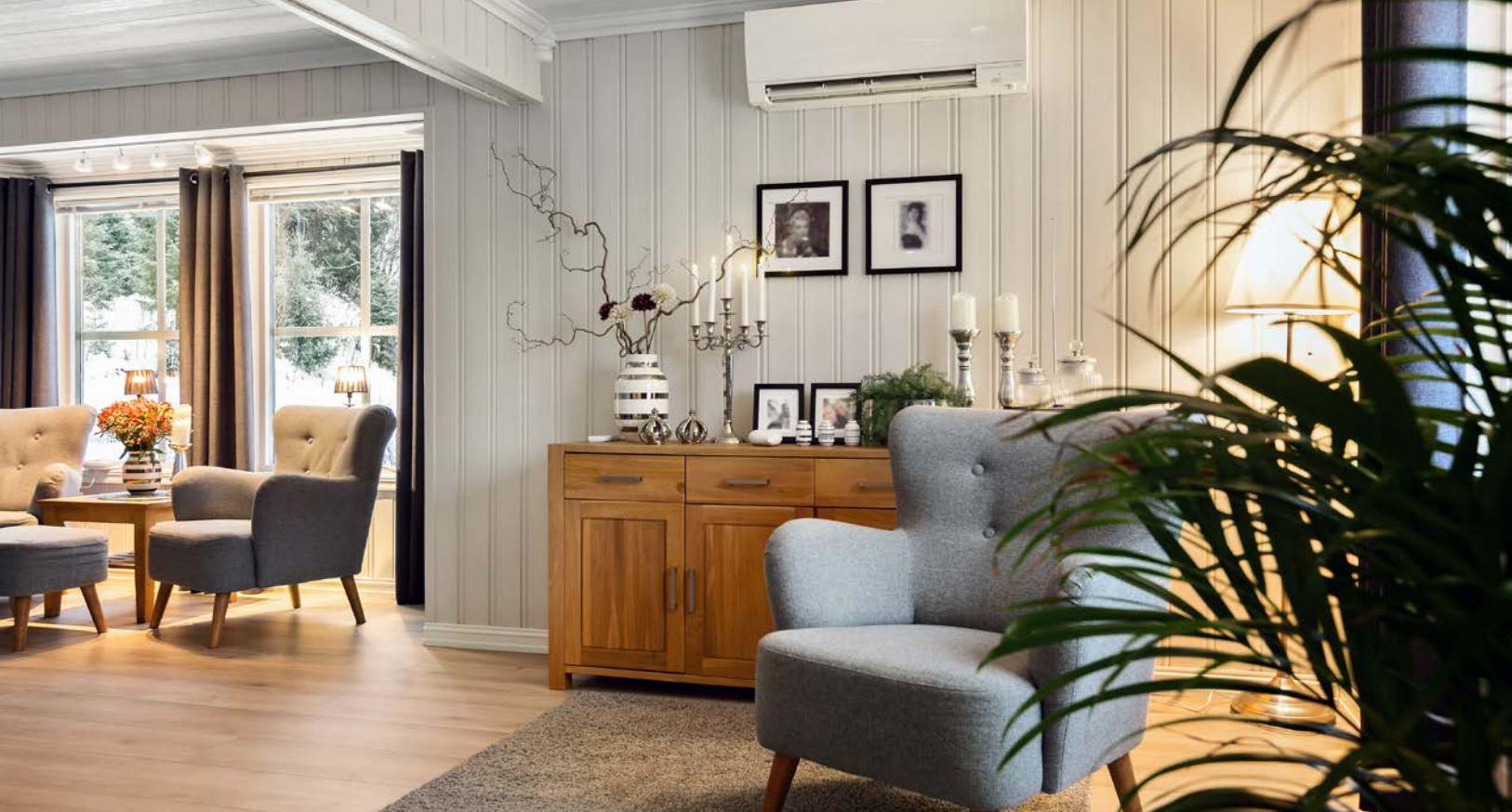
Boligen har montert varmepumpe i den ene delen av stua.
