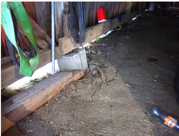
Redskapshus: Skjevheter i pilarer og utpresset vegg.
