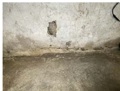
Skader i murpuss.
