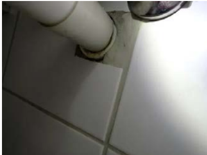
Ikke synlig mansjett/membran på rørgjennomføring i vegg under servant
