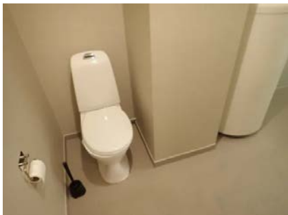
Område ved toalett og rørsjakt med motfall.
