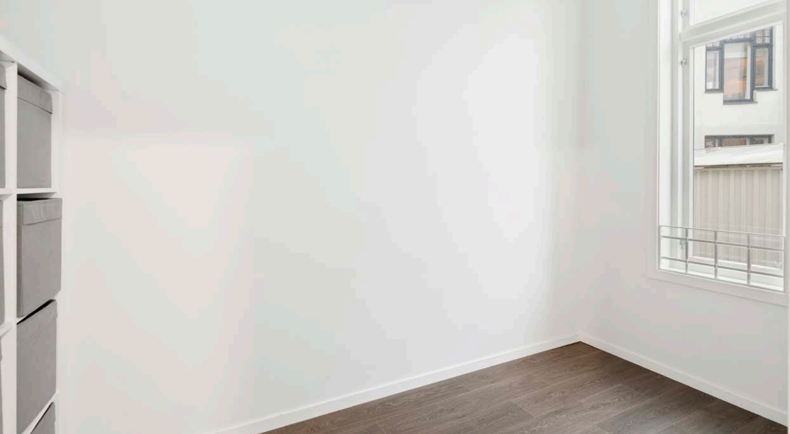
Innredet rom. Rommet er ikke ihht. areal krav for rom til varig opphold og er ikke godkjent som soverom
