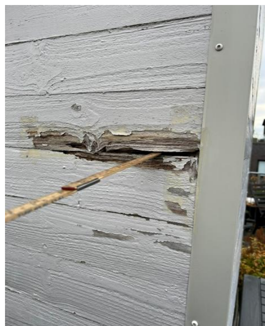
Bilde 2: Eksempel på råteskadet panel
