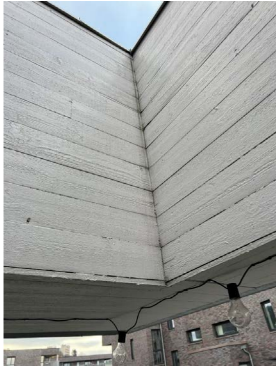
Bilde 9: Bildet viser innvendig hjørne hvor løsningen leder vann inn mot eksponert endeved på kledning.
