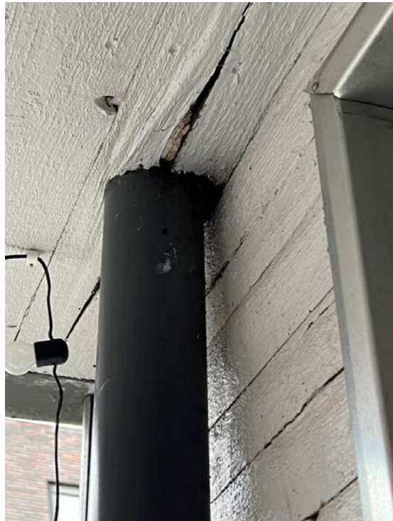
Bilde 10: Bildet viser kledning rundt nedløp hvor ubehandlet endeved trekker til seg fuktighet langs rørledningen.
