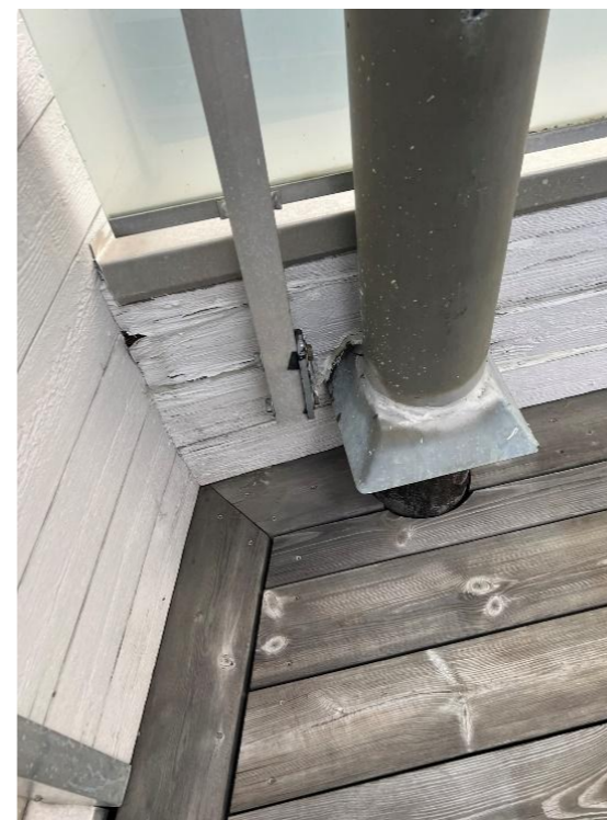
Bilde 7: Bildet viser panelt brystning. Mangelfull beslagsløsning leder vann inn mot hjørnet. Kombinasjonen med ubeskyttet endeved på panel medfører avflassing og råteskade.
