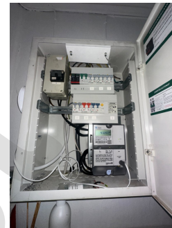
Sikringskap med automatsikringer.
