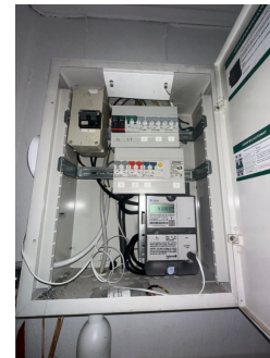
Sikringskap med automatsikringer.
