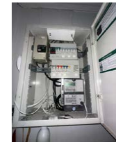
Sikringsskap med automatsikringer.
