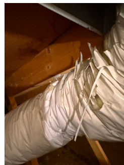
Flass av plastfolien på ventilasjonskanalen.
