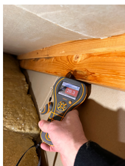
Registrert fukt i takstol mot nabo
