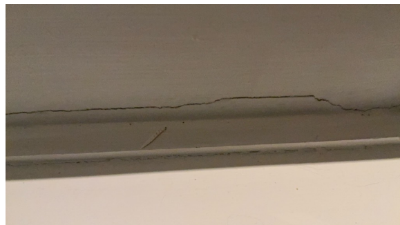
Sprekker i opptrinn
