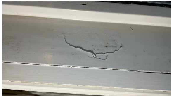
Malingsflask i vindusforing stue
