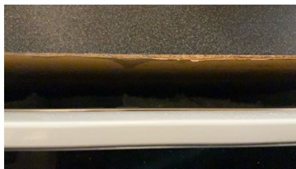
Svelling i benkeplate over oppvaskmaskin
