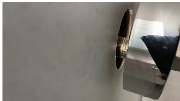
Manglende tetting rundt rørgjennomføring
