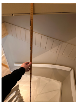
Lav frihøyde på mellom 1,8 og 1,9m
