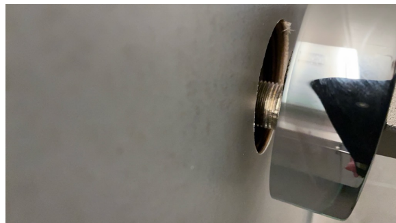
Manglende tetting rundt rørgjennomføring
