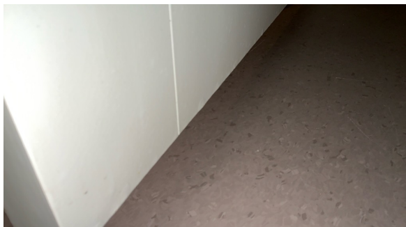
Fuktskjolder i bunn av badedør
