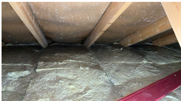
Lite lufting nede ved gesims, samt at ndertaket er misfarget.
