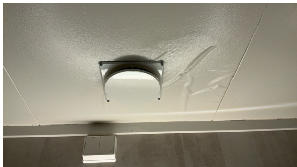
Løs folie på takplaten rundt ventil
