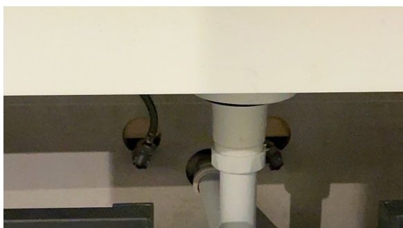
Manglende tetting rundt rørgjennomføringer
