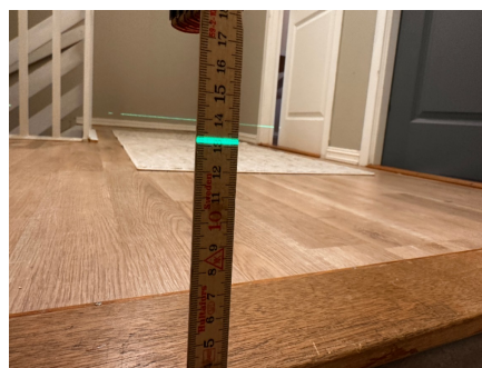
Høyde ved dørterskel 13,2cm
